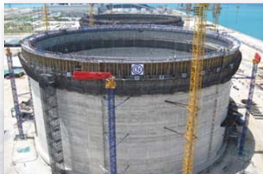
PTT LNG TANK RAYONG
